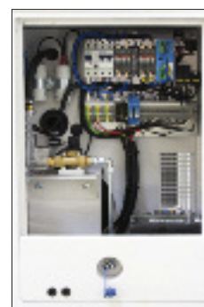
Встроенное автоматическое устройство аварийного запуска генератора (ABP)
